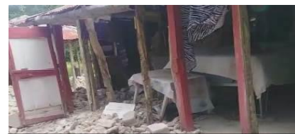
Maison traditionnelle : mur effondré.
