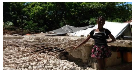
Le 14 août, la maison s'est effondrée sur cette élève de l'école.
