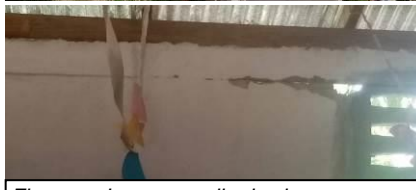
Fissures dans une salle de classe.
