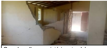
Grande salle : mur intérieur tombé.
